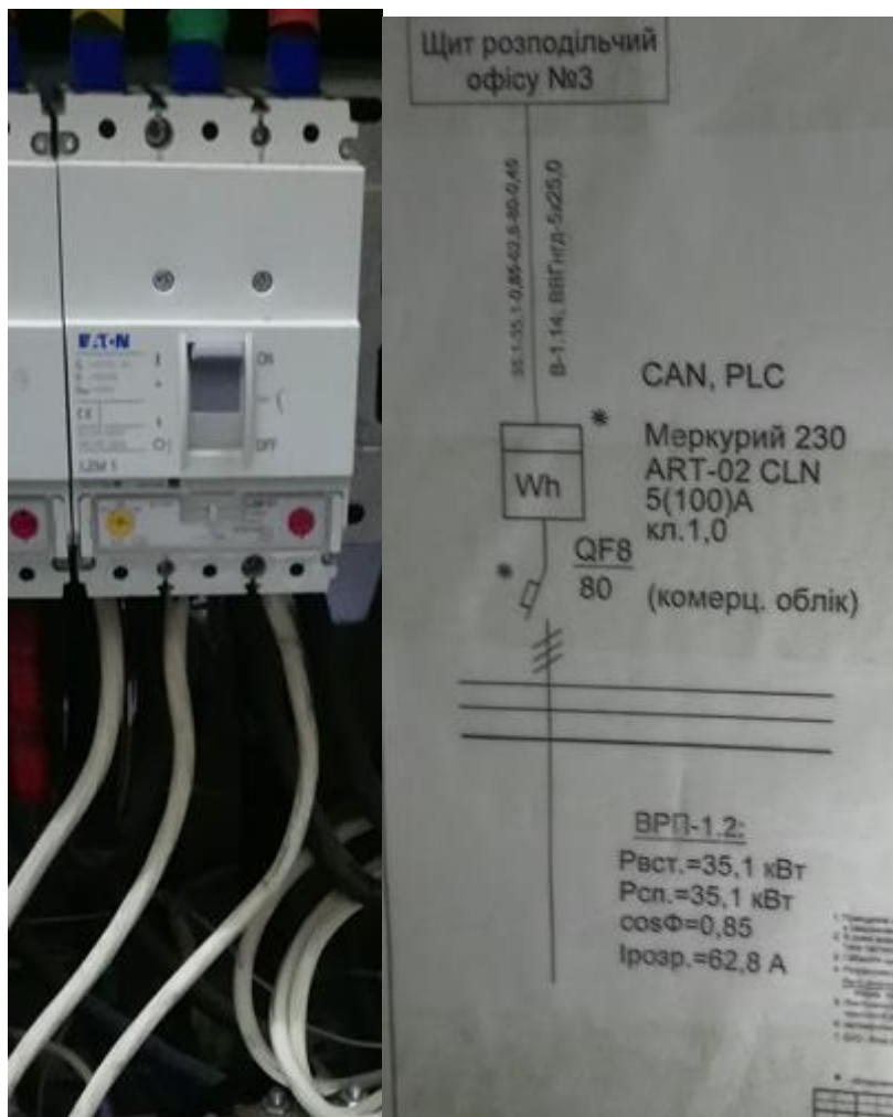
2.1.2.5. Кабель між (QF?(1)) у ВРП 1.1. та QF 8 у ВРП 1.2. «Щит розподілу офісу №3» змонтований у ВРП-1.1 незадовільно та має бути перекладений.
